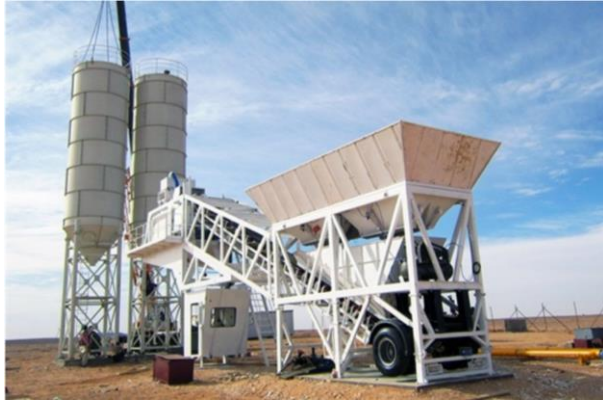
Instalación Planta Movil para Producción de Hormigón
